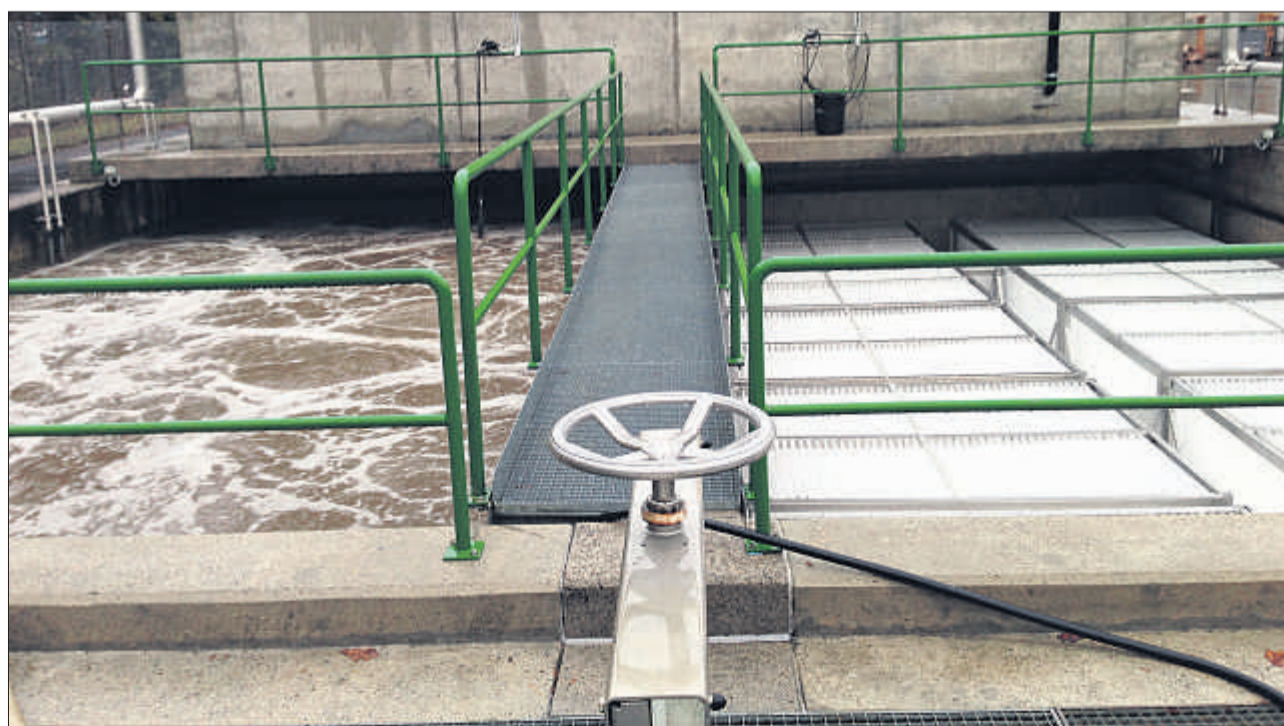
Mit dem Einbau eines Biotextilen Festbetts ist die Kapazität der rechten Biologiestrasse massiv erhöht worden.
